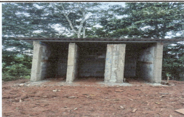
Foto1: Reparación de servicios sanitarios, debido a que se encuentra en mal estado.
